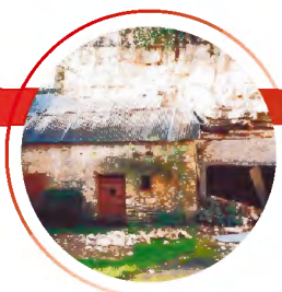
Chute blocs ( Sarthe ) ( photo : DREAL )
